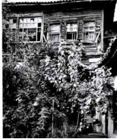
Necmi İçe Evi onarım öncesi
